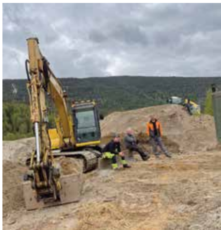
Dugnadsgjengen på plass. Her ser vi Jon Ragnar Svingen, Runar Maribo og Bjørn Ole Hilde i full gang med graving og planering. Tusen takk til alle som har bidratt og bidrar med midler, utstyr og hjelp i denne prosessen.
