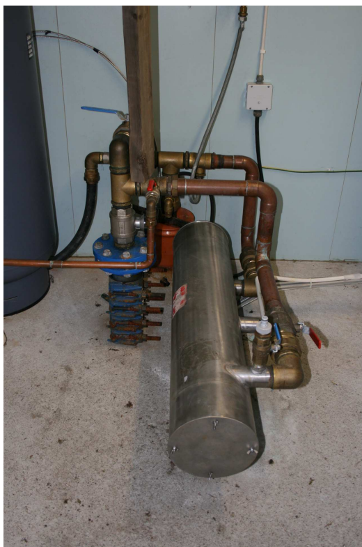
Figur 7. Behandlingsanlegg Gulsvik Vannverk
