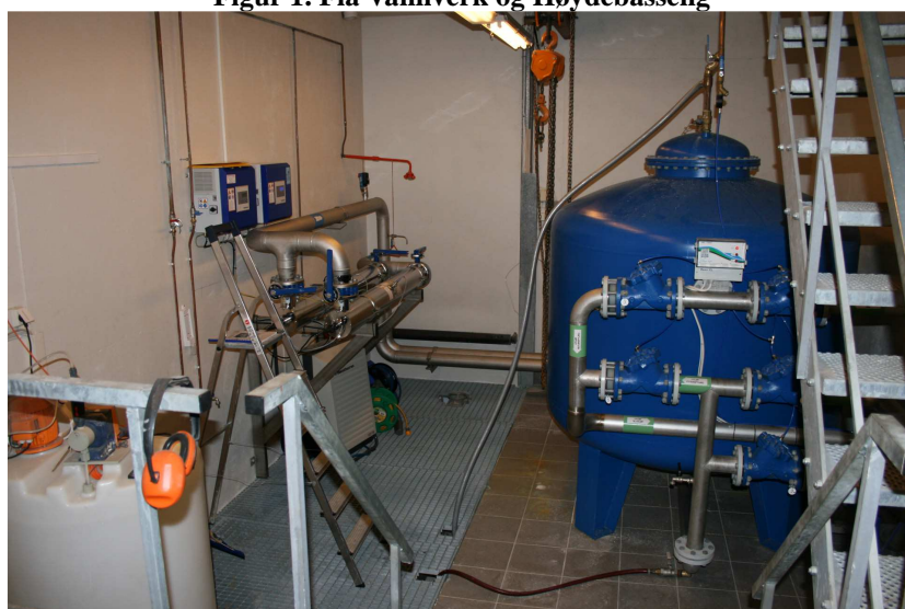
Figur 2. Behandlingsanlegg Flå Vannverk
