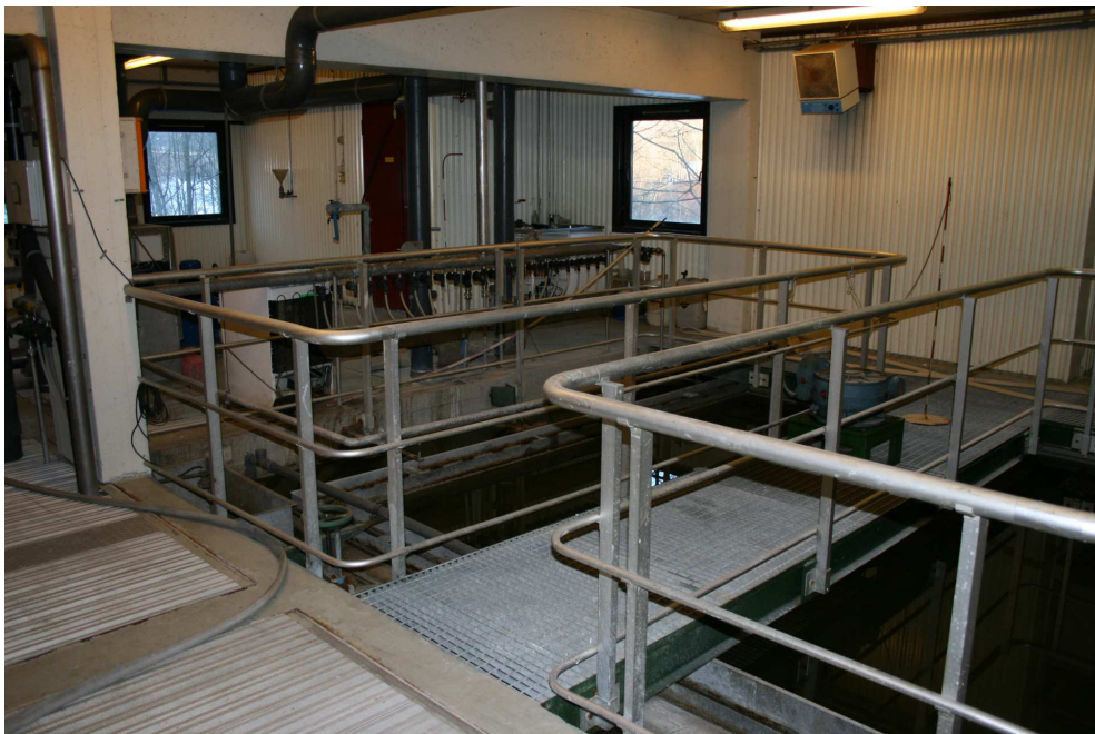
Figur 12. Innvendig Flå Renseanlegg
